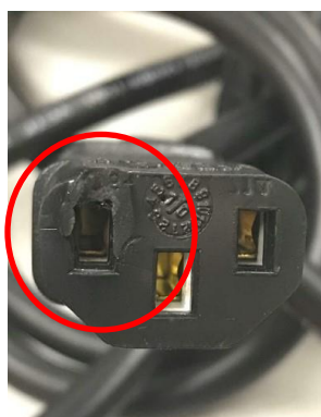
図 5- 損傷がある電源プラグ
